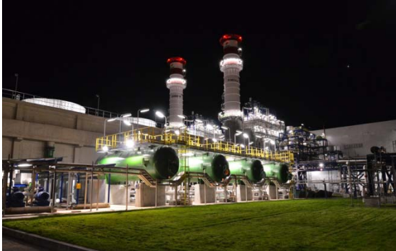
Central Térmica de Ciclo Combinado Brazi, Rumania (2x2x1 multi-eje, 865 MW)
